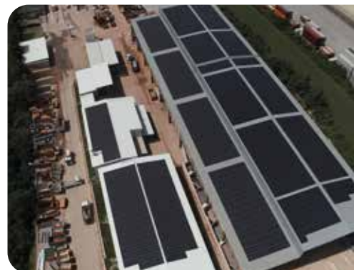
Das RCH wurde mit Photovoltaikpanelen ausgestattet.
